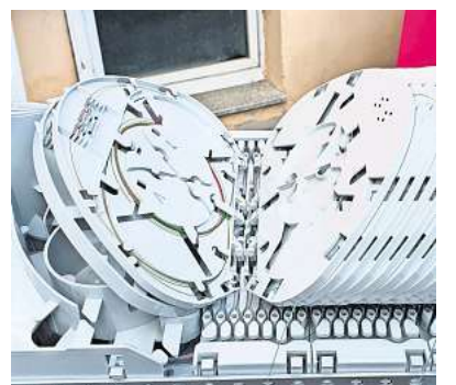
Interessante und seltene Einblicke: So sieht das Innere einer Glasfaser-Muffe aus.
